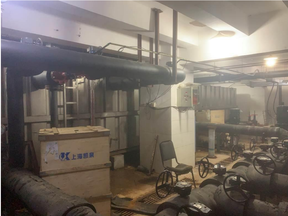
(2) 地下二层原水泵房图片：
