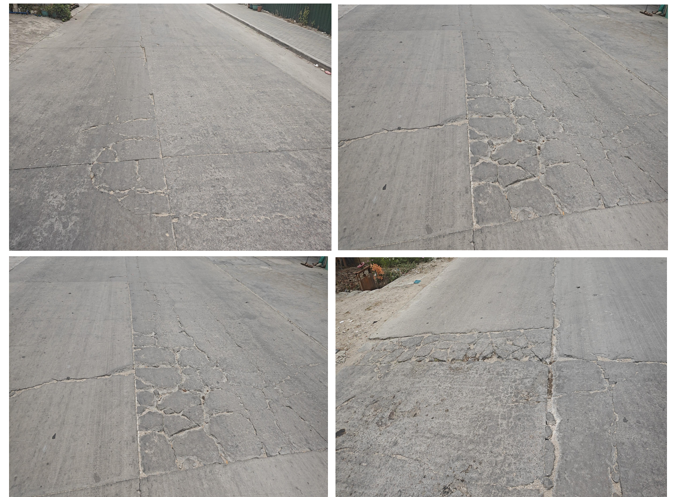
现状路面病害图
